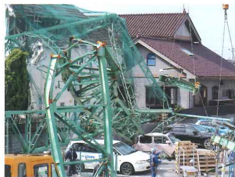
房総半島台風(2019年) 強風で倒れたゴルフ練習場の支柱
